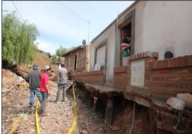
Figura Nº 1. Área urbanizada afectada por la erosión de las calles
